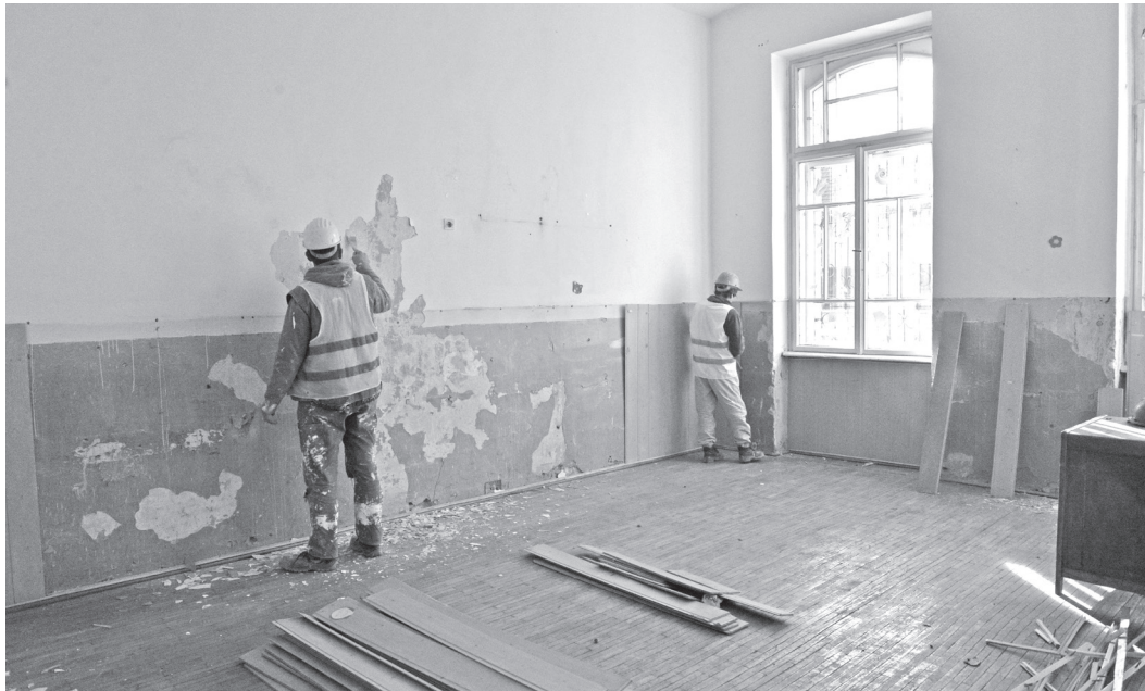
În mii de școli din România lucrările de renovare se derulează de un cincinal
